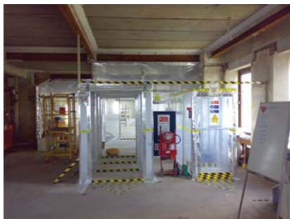
Sas d'accès à la zone confinée
