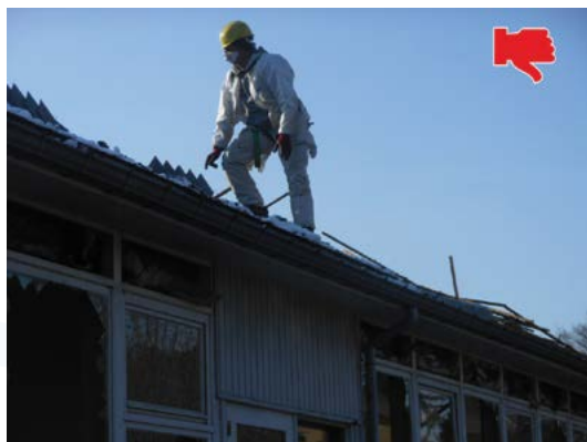
Risque de chute important
