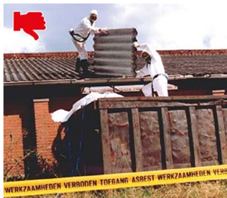
Risque de chute et de rupture des tôles ondulées
