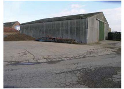
Asbesthoudende golfplaten als gevelbekleding en dak
